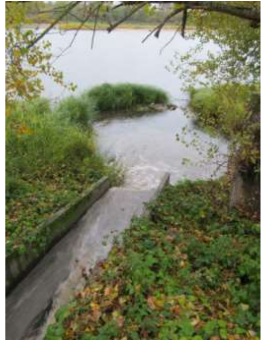
Un des déversoirs d'orage des quais de La Charité-sur-Loire en fonctionnement. BF-CENB
